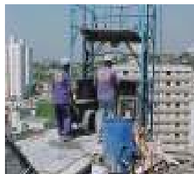
c) elevador de carga.
