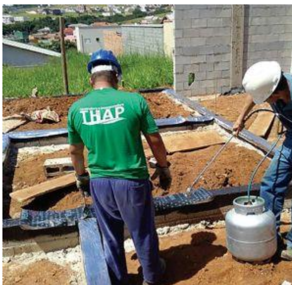
Impermeabilização de baldrame: a proteção na fase de construção da fundação rasa evita patologias futuras, geradas pelo avanço da umidade do solo nas paredes e no piso
