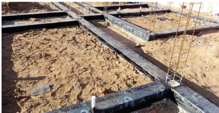
Viga baldrame: recebe tratamento com argamassa impermeável até 1 m acima do piso acabado, com camadas de tinta asfáltica sobre o capeamento
