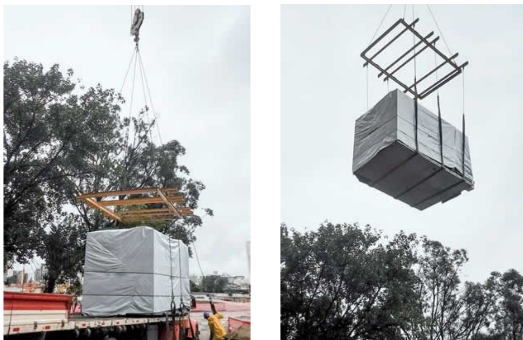
Figura 5 - Transporte vertical até a laje pode ser feito por guias, guindastes, cremalheiras ou plataformas fixas
