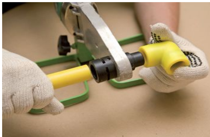
A quantidade de conexões é determinante para a escolha do sistema. Além das questões referentes à compatibilidade entre os diâmetros das tubulações, influenciam diretamente no cronograma de execução devido ao tempo que levam para serem executadas
