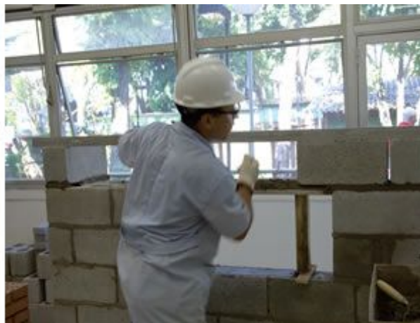
O assentamento da verga é precedido da aplicação da mesma argamassa de assentamento no escoramento, para incremento da resistência do elemento e manutenção da modulação vertical
