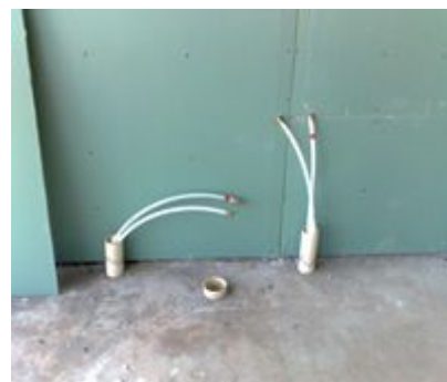
Figura 13 - Chicote hidráulico atravessando os passantes
