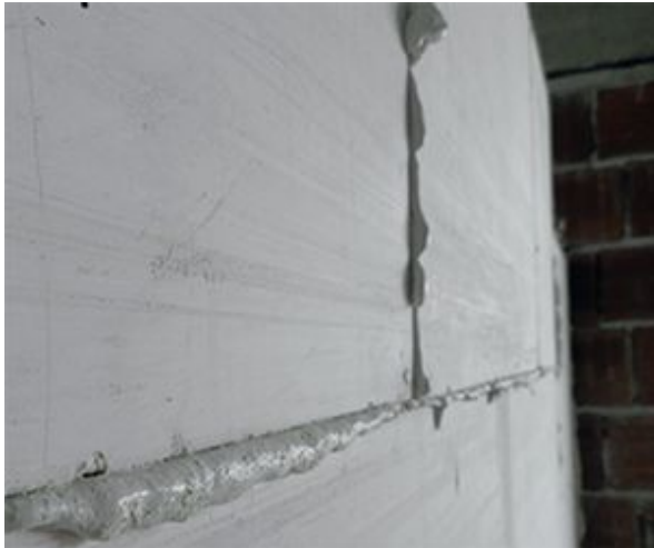
Figura 16 - Transbordo na ligação entre blocos
