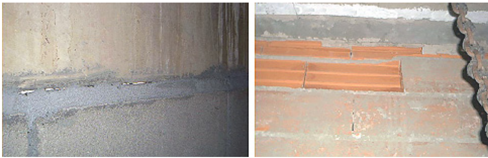
À esquerda, fixação mal preenchida com colher de pedreiro; à direita, ruptura na fixação de poço de elevador devido à utilização de bloco com baixa resistência
