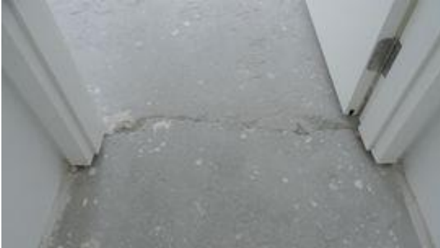
Porta instalada em etapa inadequada da obra, ainda no contrapiso
