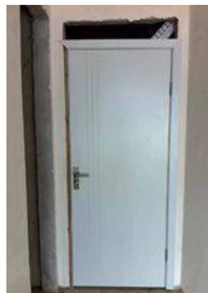
Falha no projeto e na verificação do vão, que tem altura maior do que a do kit
