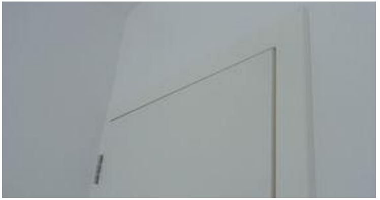
Empenamento de porta, problema que pode ocorrer por deficiências de projeto e exposição à umidade de porta sem resistência
