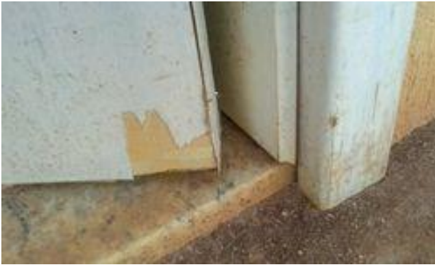
Danos causados pela exposição de porta interna a intempéries
