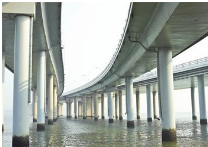
Estruturas de concreto em contato com o mar têm maior vulnerabilidade nas pontes sujeitas à variação da maré
