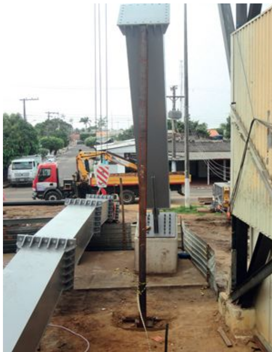
Estruturas metálicas devem ser firmemente ancoradas em base de concreto
