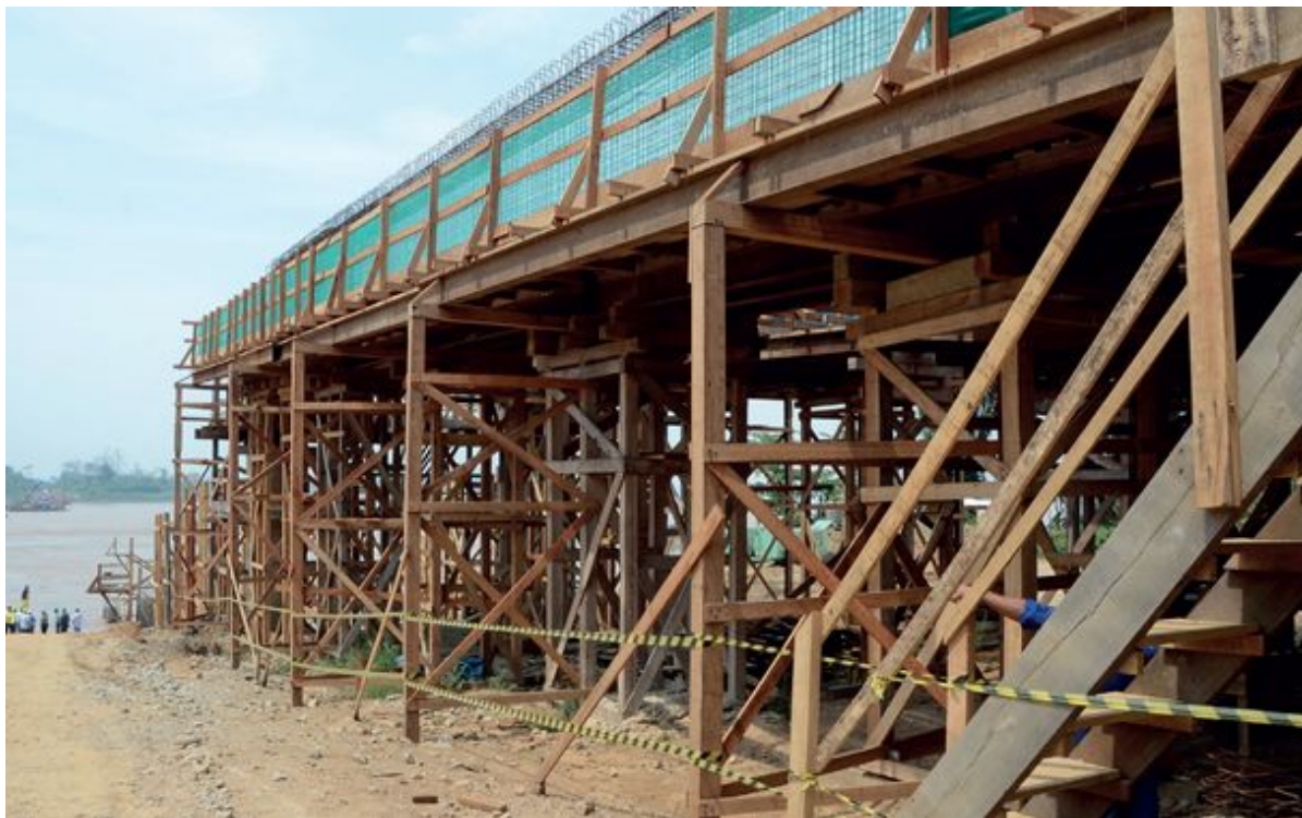
Grande parte da madeira consumida nas obras brasileiras é utilizada na fase de construção, com usos temporários em fôrmas e escoramentos
