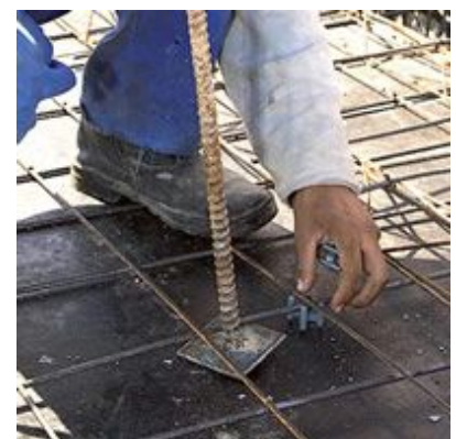
Alguns tipos de espaçadores podem ser posicionados após a montagem da armadura, com auxílio de uma alavanca
