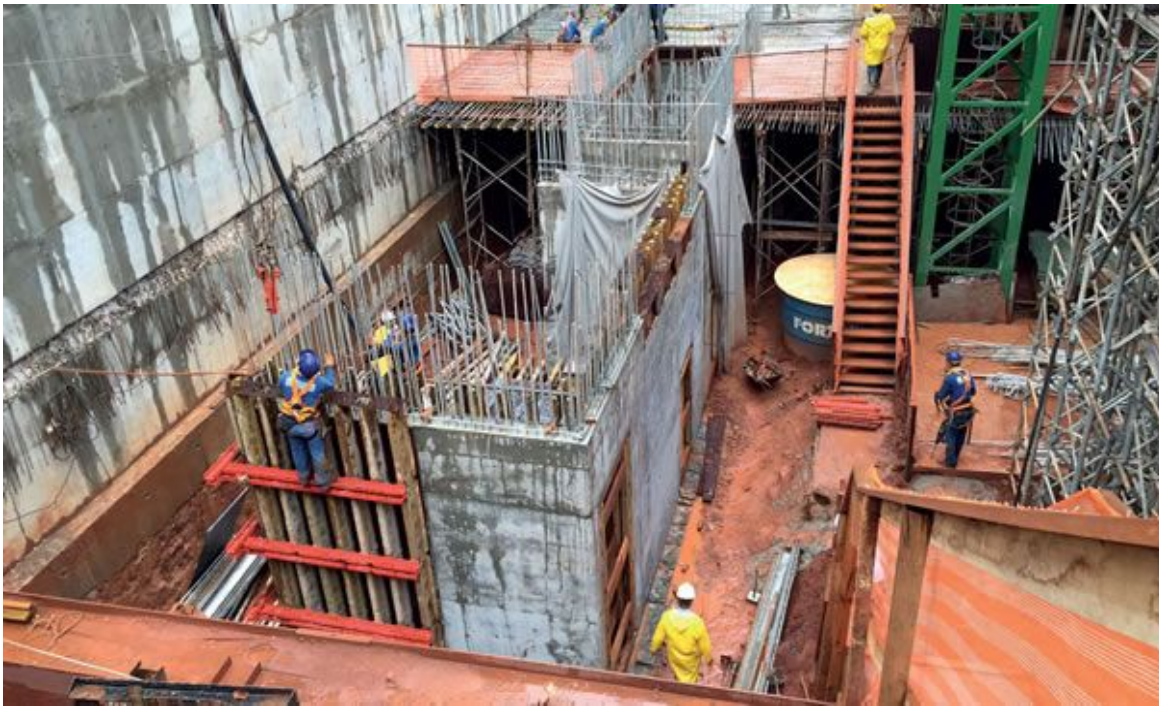
Figura 3 - Detalhe das armaduras galvanizadas na estrutura do edifício que abrigará o Instituto Moreira Salles, na avenida Paulista
