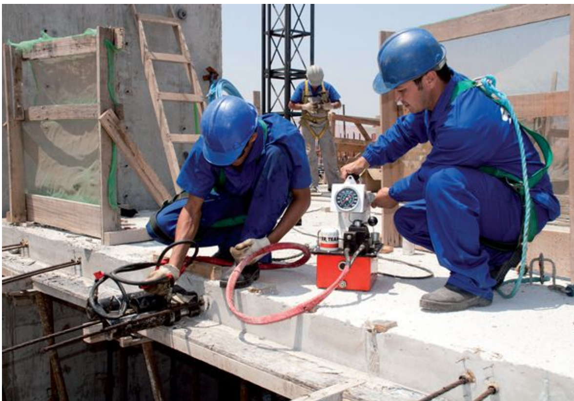
Etapa mais crítica do serviço é a da protensão em que o aço é submetido a uma tensão de cerca de 80% de sua resistência
