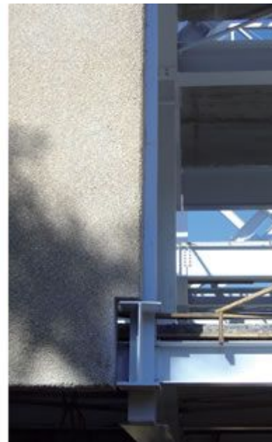
Compatibilização dos pré-moldados com a estrutura deve ser prevista em projeto
