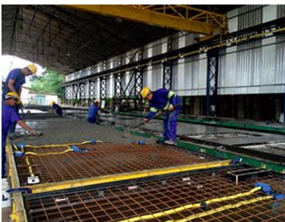
Figura 1 - Vista geral da unidade de produção dos painéis
