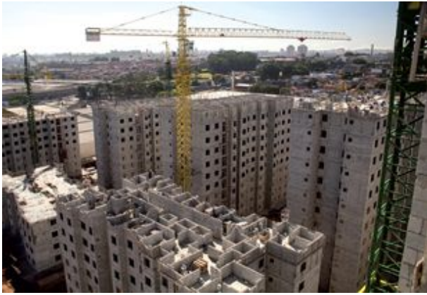
Equipamentos de transporte vertical devem ser corretamente dimensionados e posicionados para evitar desabastecimento das frentes de trabalho
