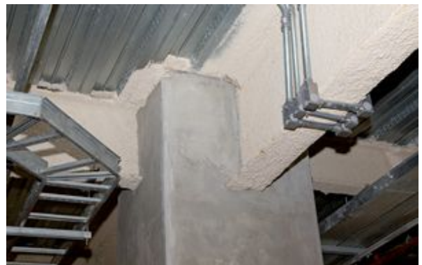
Compatibilização dos projetos deve culminar na melhor solução global para o edifício. Nesse caso, o cabeamento corre por fora da laje steel deck e da viga de aço
