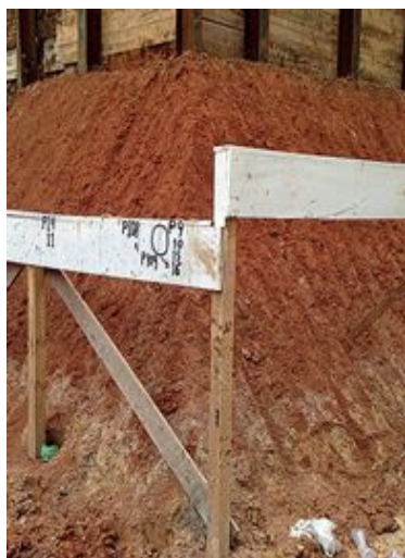
Figura 2 - Detalhe de canto em gabarito com desnível das tábuas adjacentes
