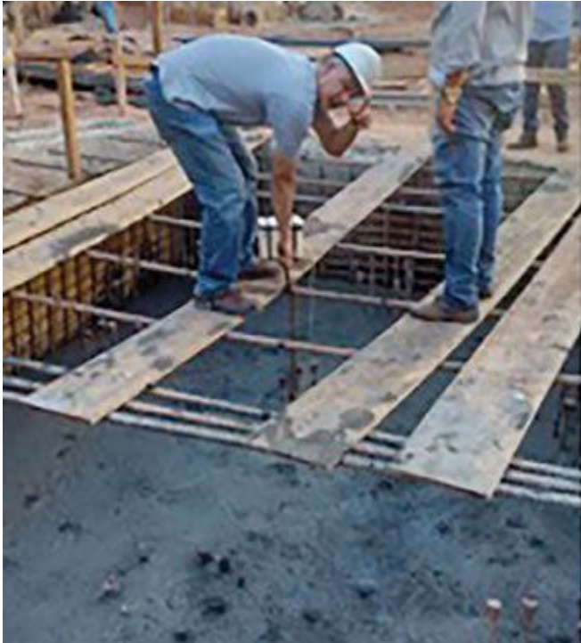
Instalação de termopar para monitoramento da temperatura do concreto no bloco de fundação
