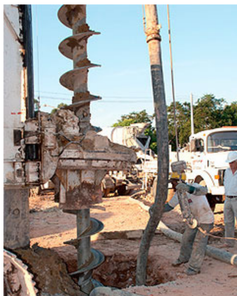
Estaca hélice contínua: maior ocupação da mão de obra e fornecimento contínuo de concreto
