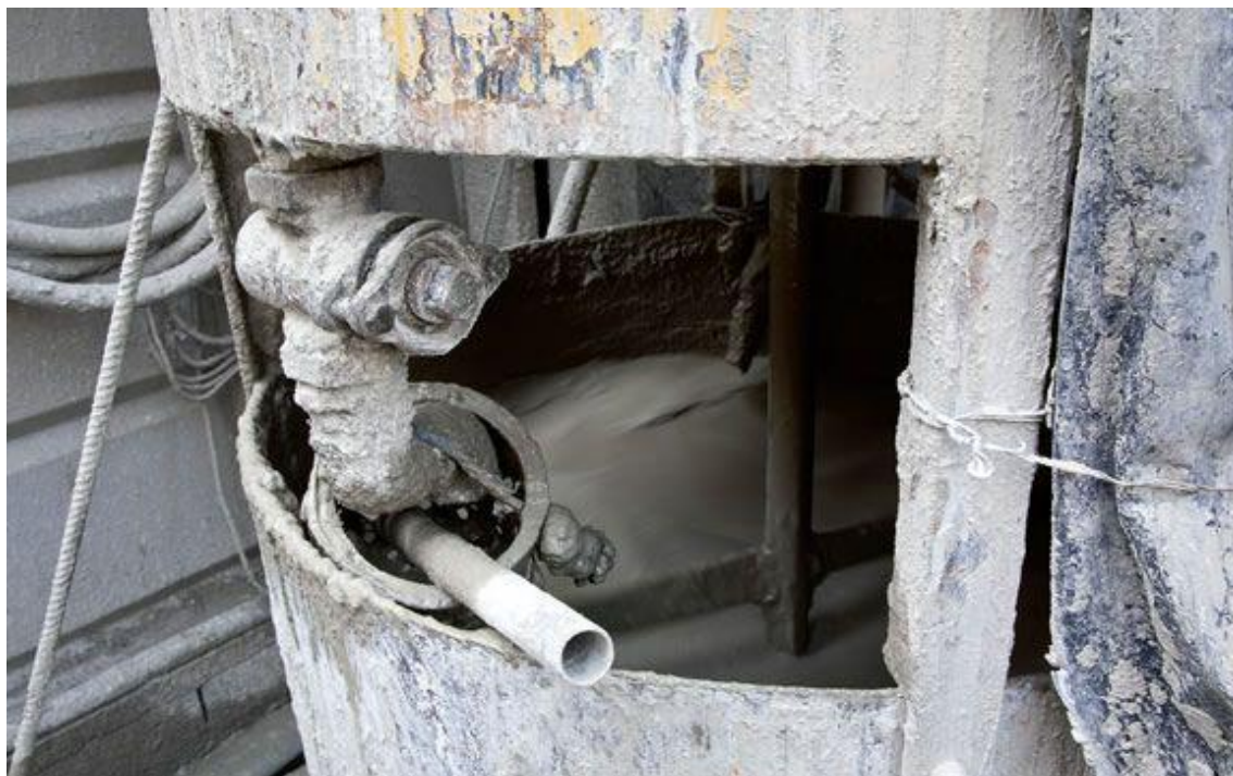
Central de produção de calda de cimento
