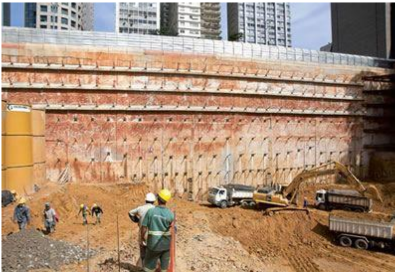
Tirantes da parede de contenção na divisa com a Avenida Paulista foram executados em ângulos diferentes, com cuidado para não interferirem no túnel do metrô
