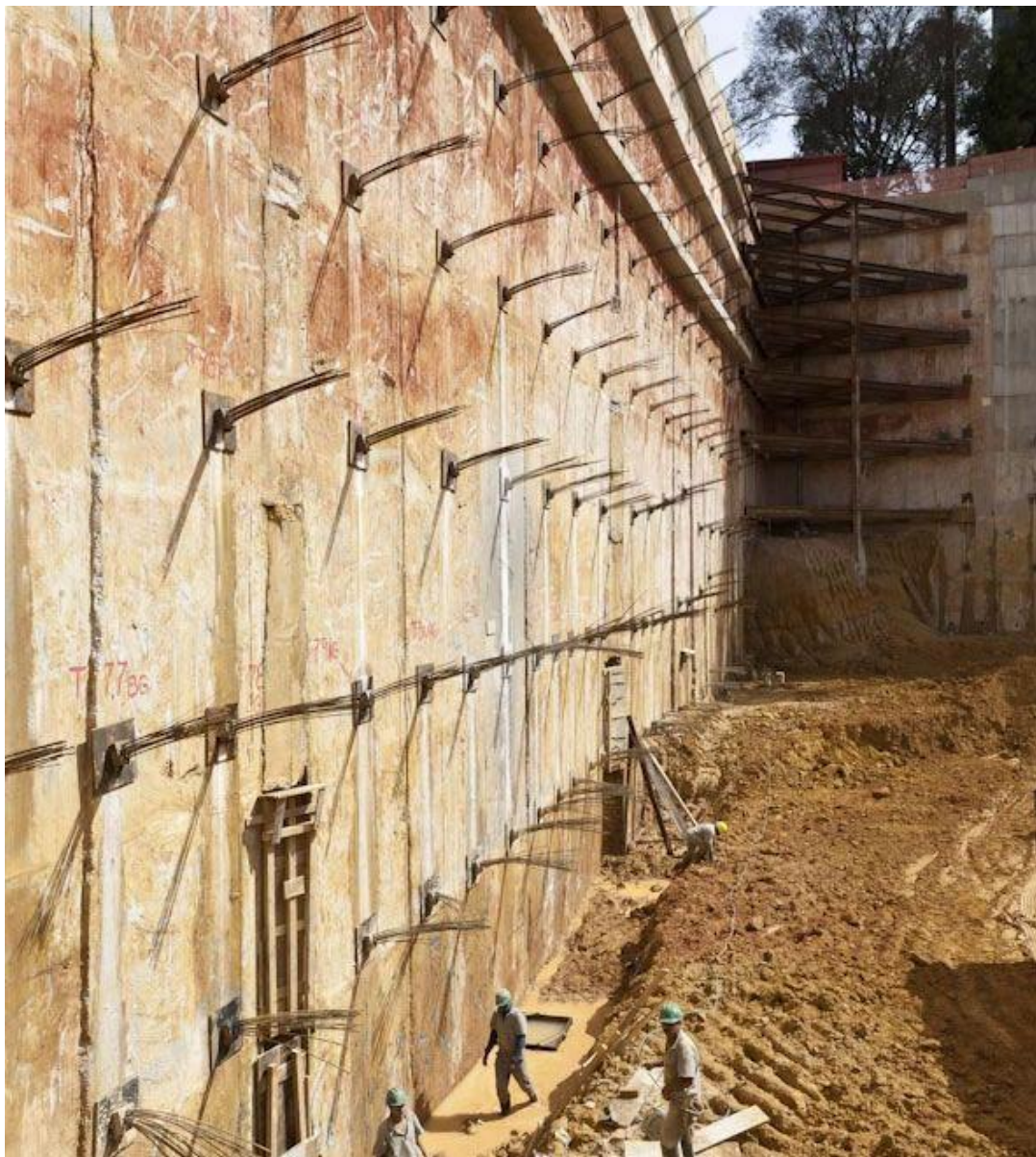
Ângulo dos tirantes executados na parede diafragma junto à avenida Paulista foi cuidadosamente estudado para não interferir no túnel do metrô
