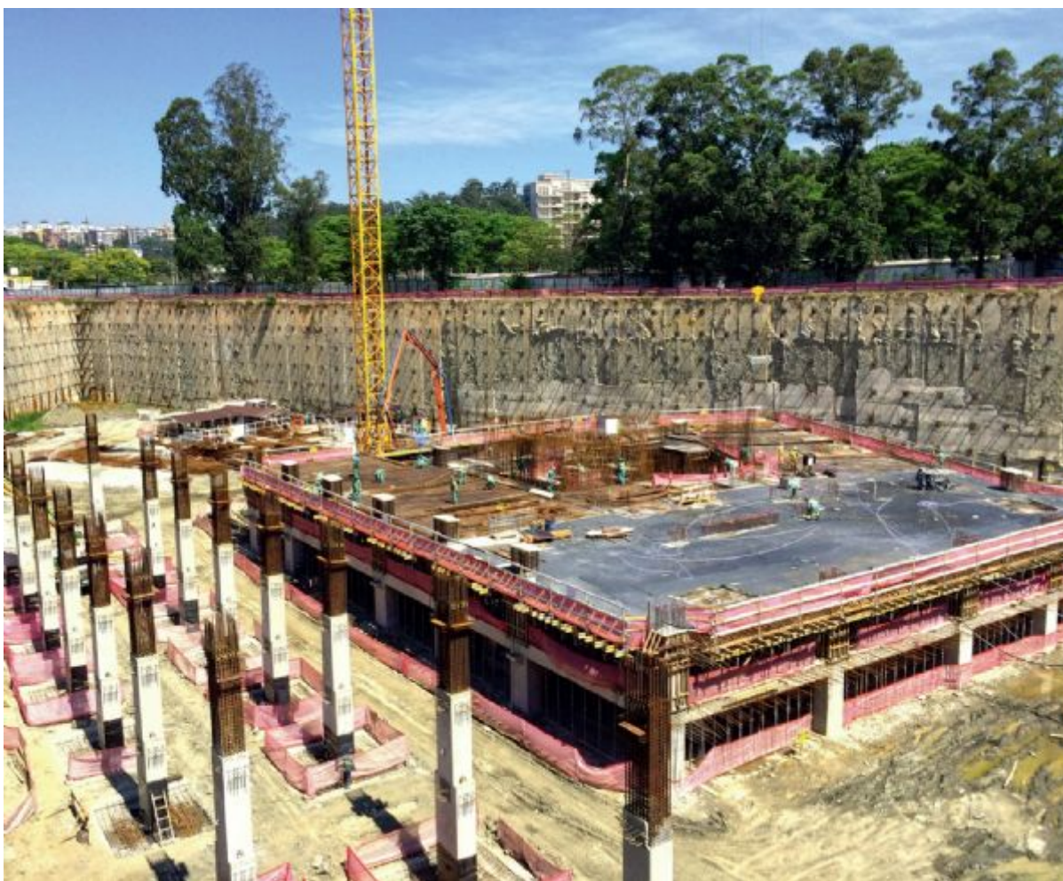
Sistema de contenção da gleba A foi um dos maiores desafios executivos do projeto
