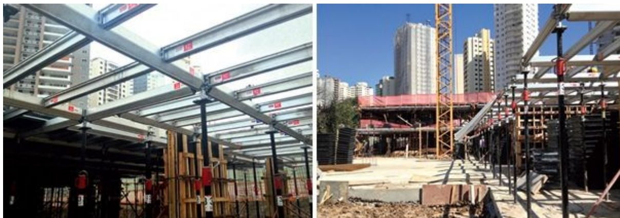
Sistema de escoramento de alumínio acelerou a produção no canteiro de obras e reduziu o consumo de madeira na obra
