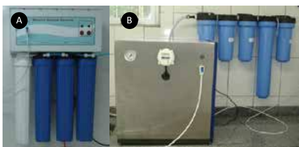
Foto 3 – Sistema de Osmose Reversa para purificação de água, associados à pré-filtração.
