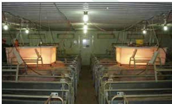
Foto 3 - Vista de uma sala de maternidade com dois decks instalados
