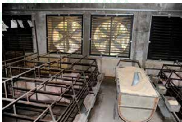
Fotos 1 e 2 - Sistema de climatização em túnel em gestação. Vedação do teto e das laterais e entrada de ar resfriado numa das extremidades do barracão, com exaustão na outra extremidade.
