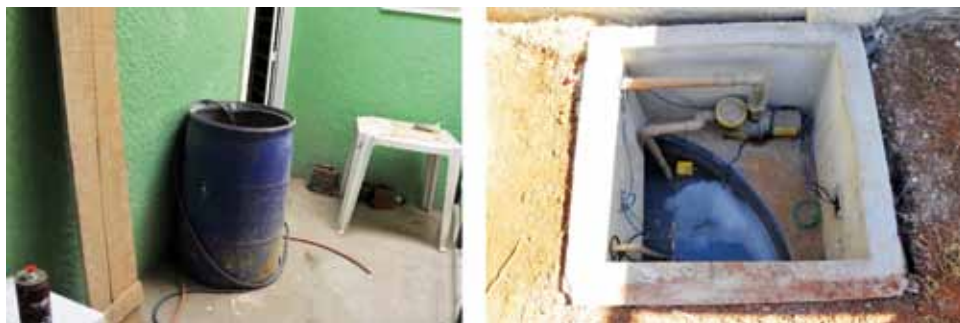
Figura 13. Depósitos de água ao nível do solo.
