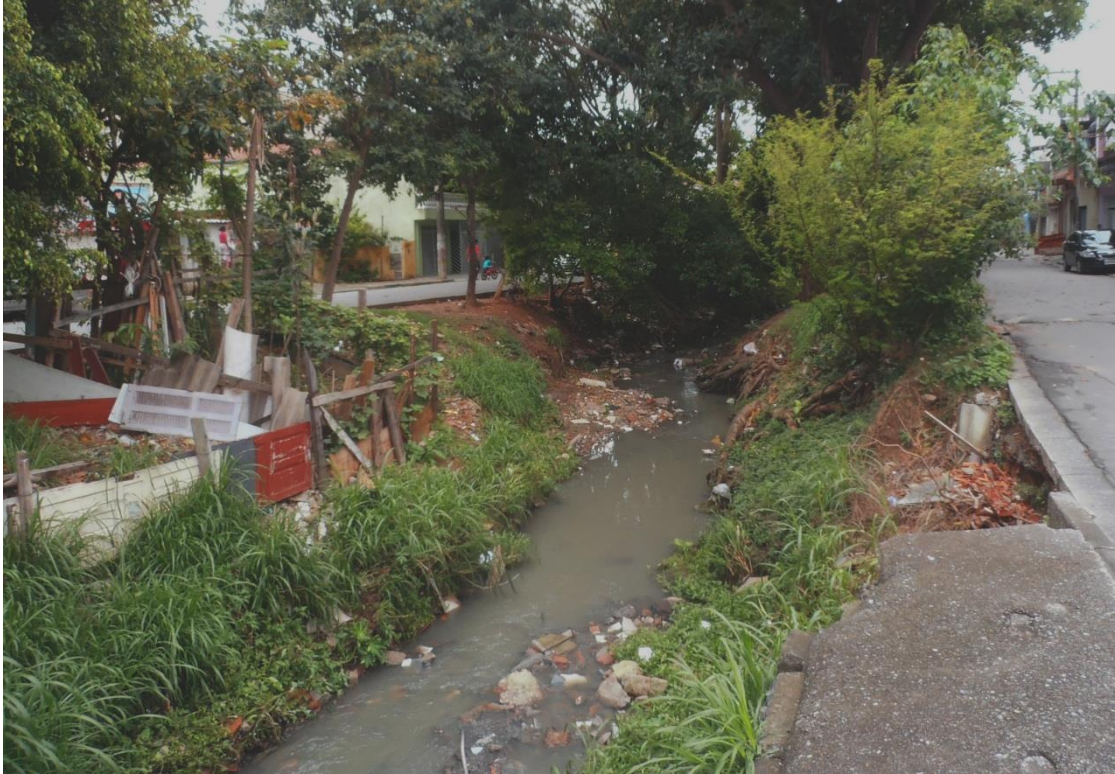
Foto 4.15 – Vista do estado do Córrego Água Podre pela presença de lixo e resíduos
