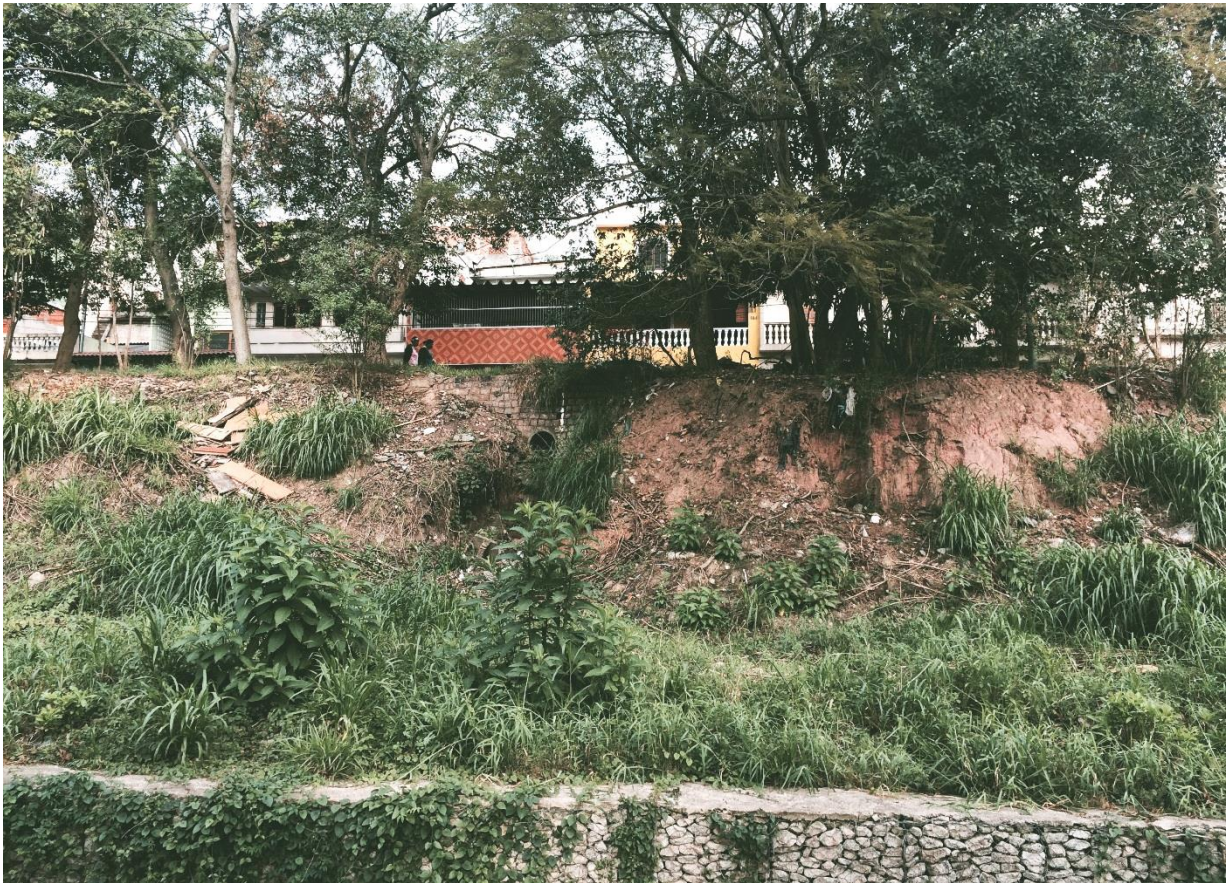
Foto 4.23 – Situação da encosta no trecho 2 do Córrego Água Podre
