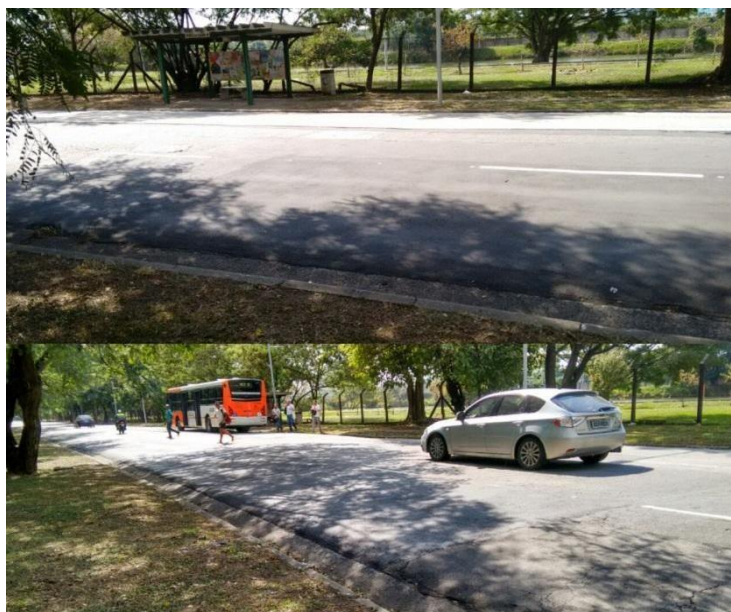
Figura 8 – Ausência de faixa de pedestre – Ponto de Ônibus Psicologia
