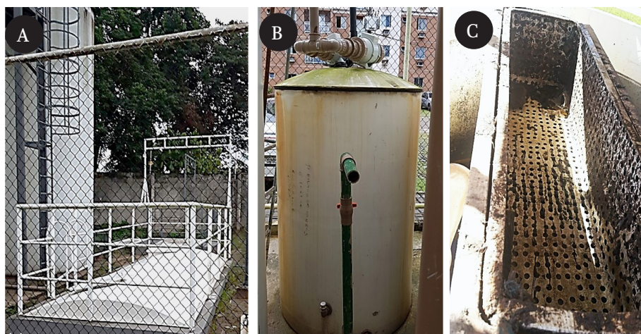
Figura 6.15 – Registro fotográfico de unidades e de instalações relacionadas ao gerenciamento de subproduto sólido de ETED implantadas em empreendimentos habitacionais (a. Cobertura em PRFV e talha manual para controle de odor e retirada de subproduto sólido do tratamento preliminar; b. Sistema de exaustão e tratamento de odor para subproduto sólido gerado no tratamento e c. Sistema de retenção em PRFV para retenção de sólidos grosseiros na entrada do sistema de distribuição de reator UASB)
