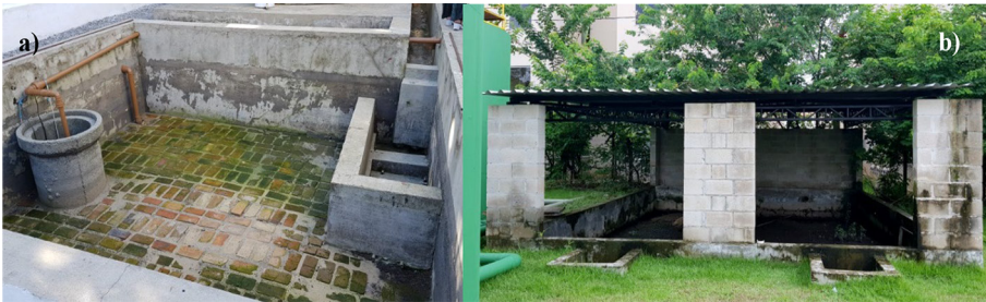
Figura 6.8 – Leitos de secagem convencionais para de desaguamento de lodo[(a) descoberto e (b) coberto] implantados em ETED de empreendimento habitacional em Maceió (AL) e em Ananindeua (PA)
