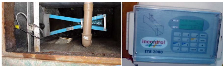
Figura 2.9 – Calha Parshall e elementos secundários de medição de vazão (sensor de nível e conversor de dados)
