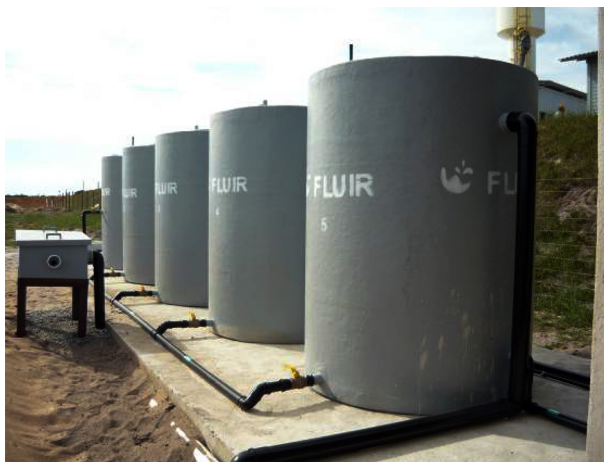
Figura 5.11 – Estação de tratamento de um condomínio residencial dotada de um RAC (os três primeiros tanques da foto) seguido de um filtro biológico aerado submerso (tanque de aeração e decantador secundário)
