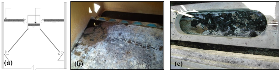
Figura 6.4 – (a) Identificação dos pontos de acumulação de espuma em reatores UASB; (b) espuma na superfície do decantador; (c) espuma no interior do separador trifásico
