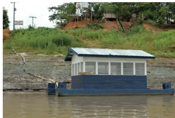
Figura 17 - Captação flutuante em balsa metálica.
