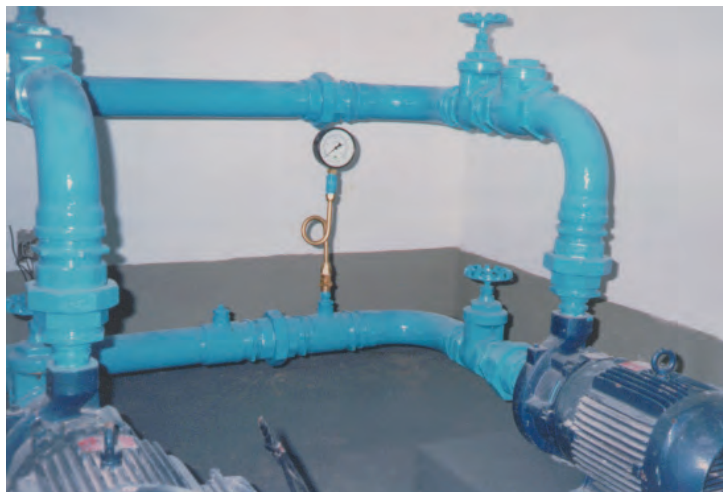
Figura 46 - Conjunto de bombeamento de uma estação elevatória de água tratada.
