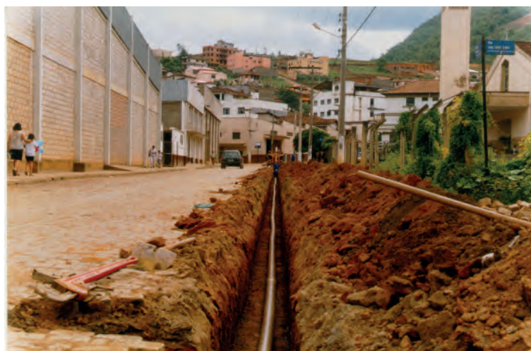
Figura 45 - Rede de distribuição em PVC com junta elástica.
