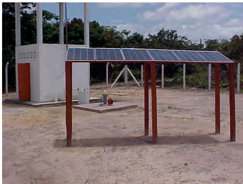
Figura 51 - Conjunto de módulos fotovoltaicos e bomba submersa instalados em poço tubular.
