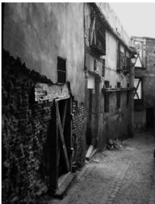
2.33. Vista de las fachadas ruinosas de la bajada de Pozo Amargo.
