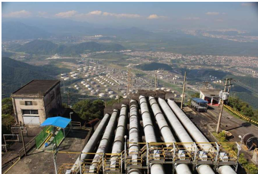
Tubulação hidrelétrica de Henry Borden (Cubatão - SP)
