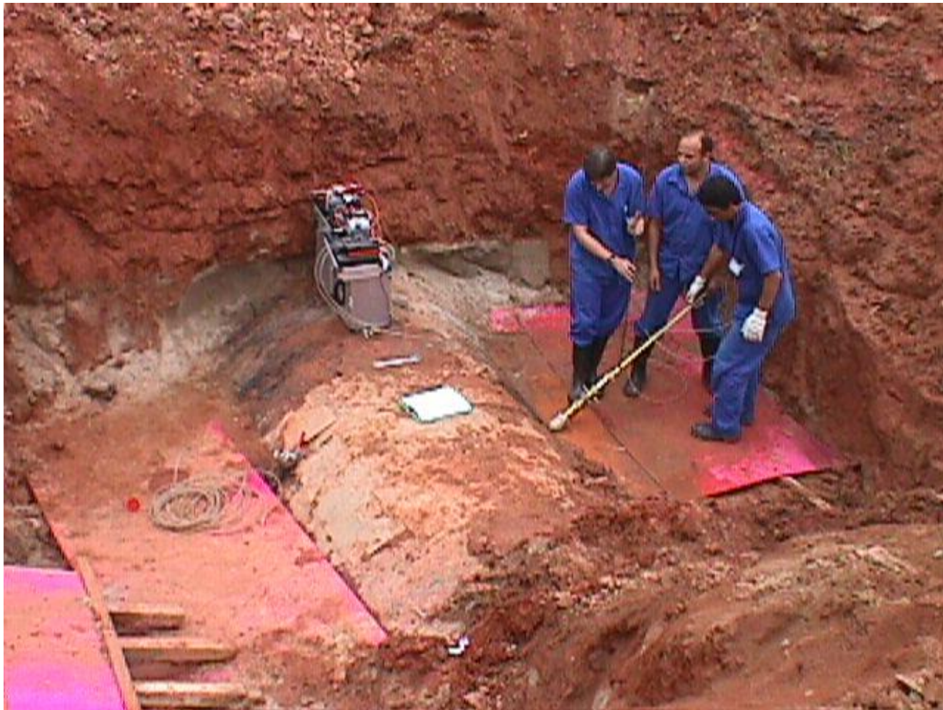
Medição com Pitot, vazão de 10 \text{ m}^3/\text{s}
