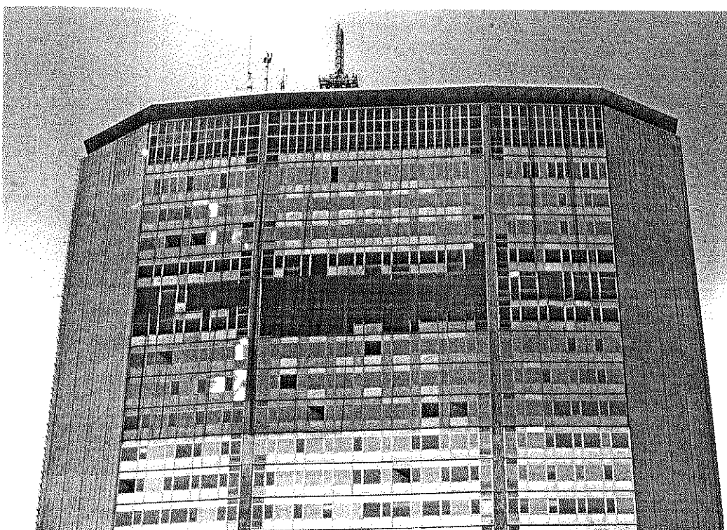
Fig. 5. A parte superior do arranha-céu depois do acidente aéreo; além das fachadas dos 25º, 26º e 27º andares, destruídas pelo monomotor, notam-se partes da armação metálica torcidas e fora do prumo, painéis transparentes e opacos arrancados e grande parte das vidraças do 31º andar despedaçadas.
