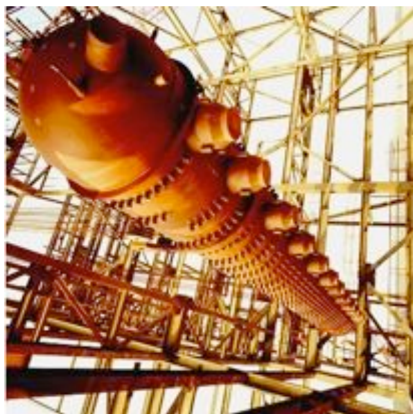
Tubulão de vapor
