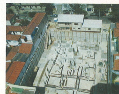
Foto 8 – As cortinas são travadas com as lajes do subsolo e do térreo
