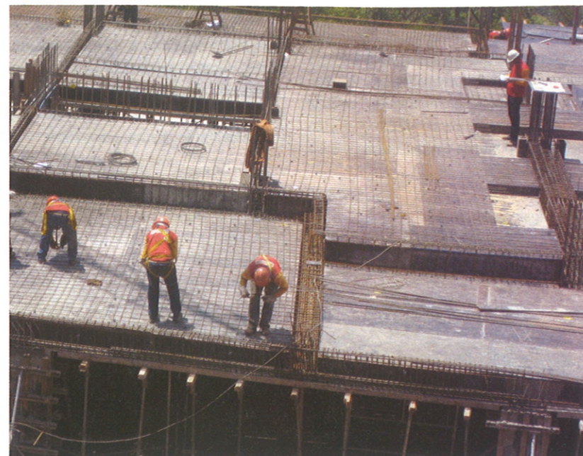
A estrutura como um todo é um gargalo da execução da obra. A produtividade pode ser uma ferramenta para tomada de decisões de projeto
