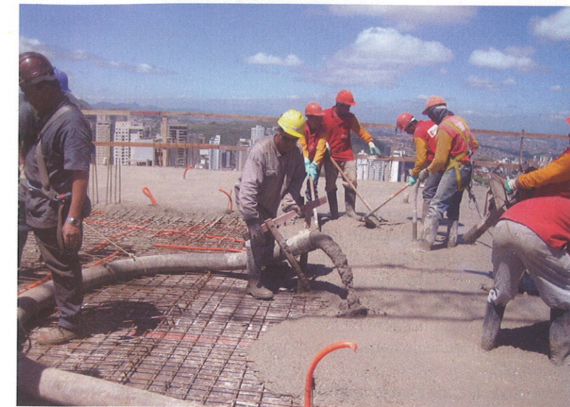
O concreto convencional pode ser mais barato, mas é menos produtivo, pois demanda mais pessoal e mais tempo de serviço
