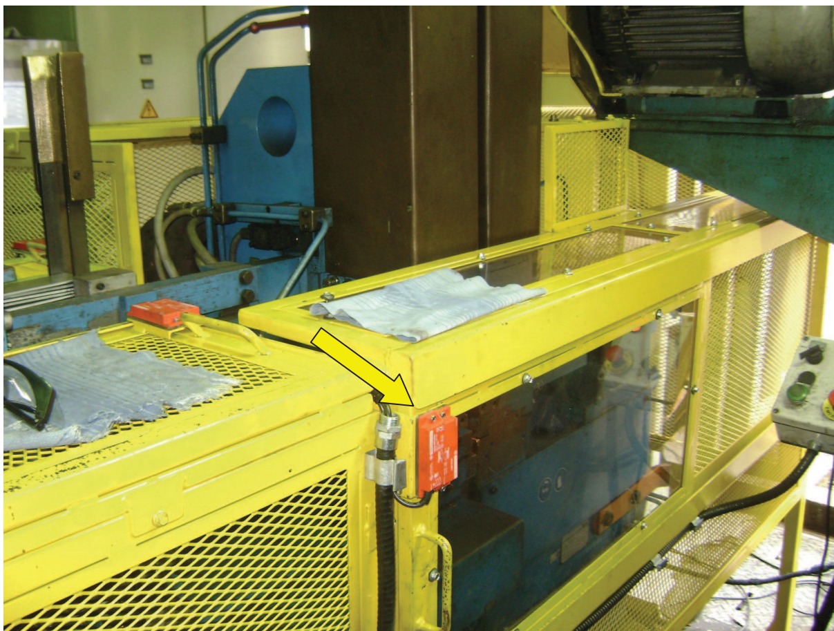
Figura 10 – Enclausuramento da zona de prensagem por proteções móveis Intertravadas - fechada
