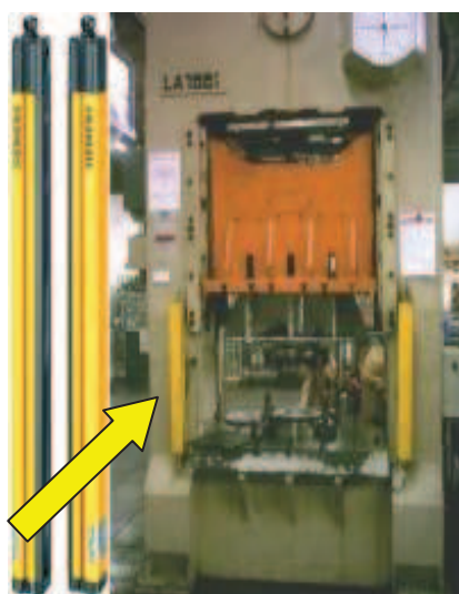
Figura 24 – Cortina de luz instalada.
