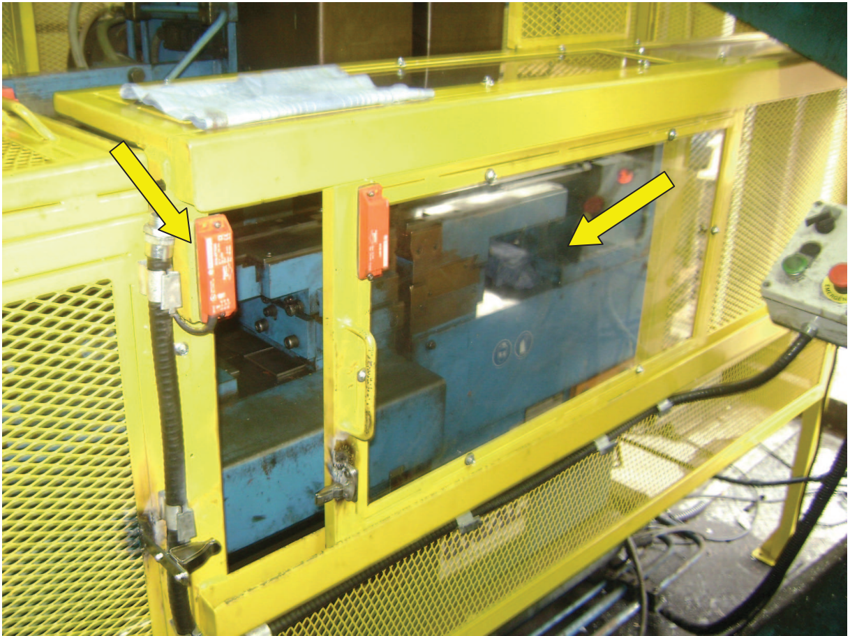
Figura 11 – Enclausuramento da zona de prensagem por proteções móveis Intertravadas - aberta
