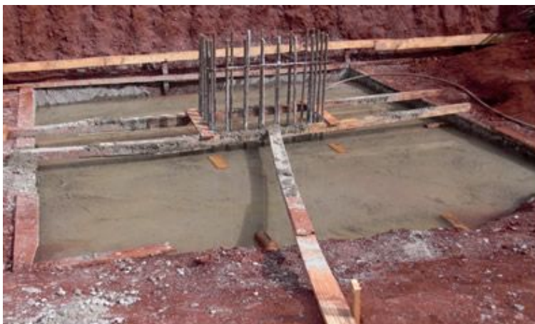
Figuras 9 - Barreira de contenção para impedir o vazamento da água sobre bloco de coroamento
