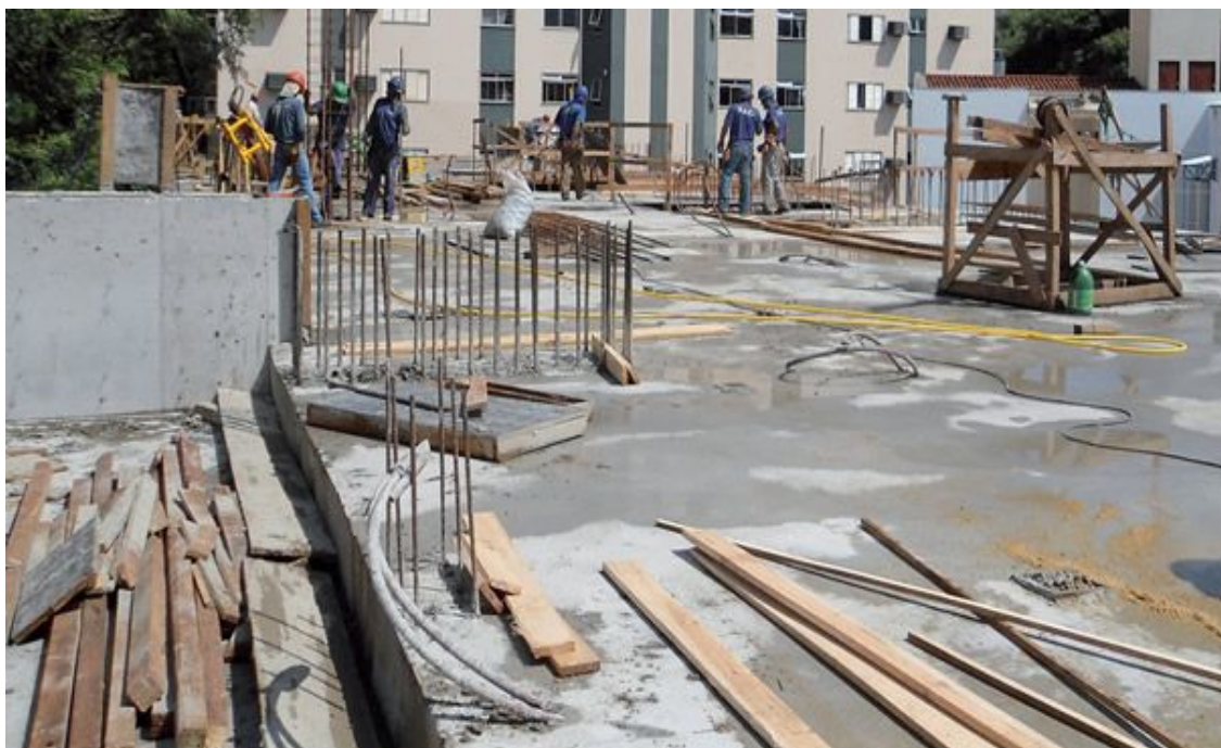
Figura 16 - Continuidade dos serviços de execução da estrutura durante o processo de cura
