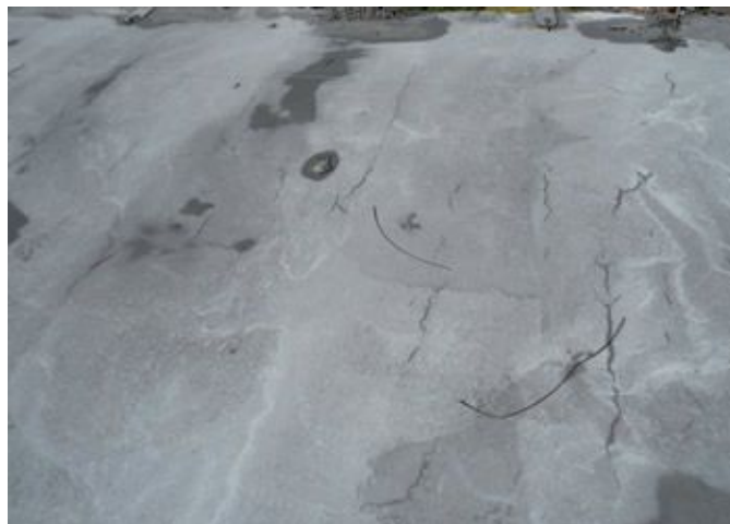
Figura 1 - Fissuras por cura inadequada do concreto (vista superior da laje)
