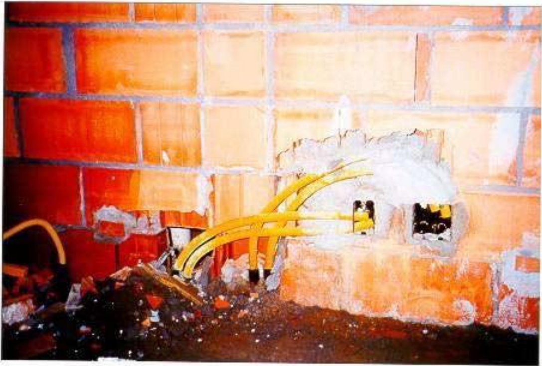
Figura 3.1 – Saída da laje dos conduítes na posição errada.
