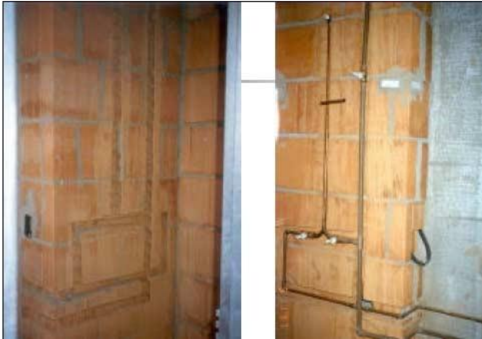
Figura 4.15 – Instalações hidráulicas feitas em cortes na alvenaria de blocos cerâmicos.
