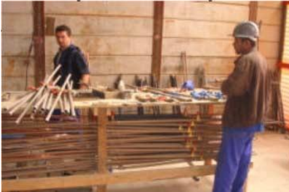
Figura 4.1 – Central de produção de instalações prediais.
