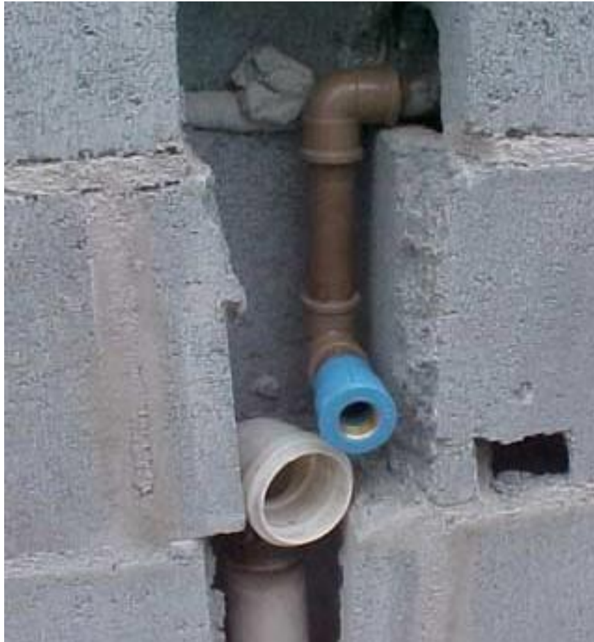
Figura 3.2 – Saídas de água e esgoto muito próximas.
