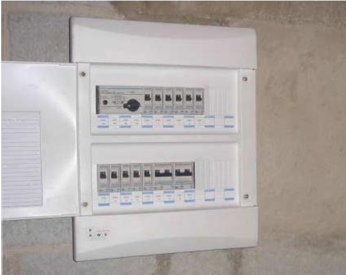
Figura 5.21 - Foto dos dispositivos de proteção.
