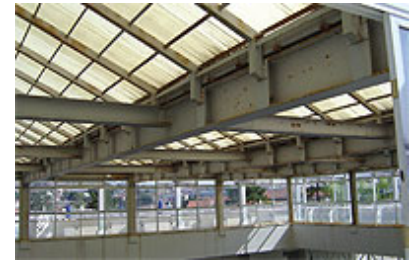
Figura 3 - Situação em que o acesso para inspeção e reparos é muito dificultado. Não existe espaço para o trabalho com o ferramental de manutenção. Trata-se da cobertura de uma piscina aquecida
