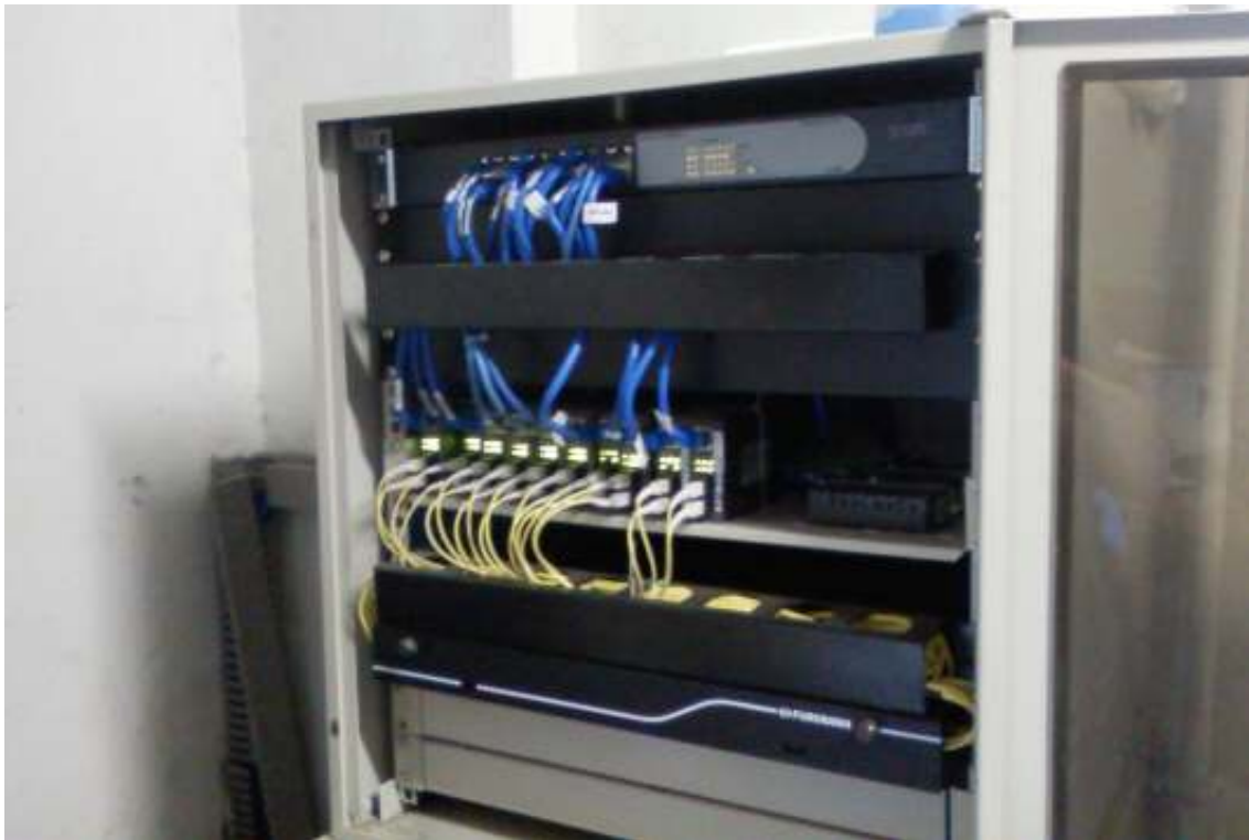
Figura 16: Switch do Sistema de Supervisório Existente (FONTE: Usina Univalem, 2011)
