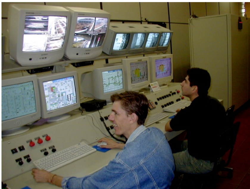
Sala de Controle das Caldeiras - Usina Santa Elisa
