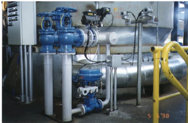
Automação de um Cozedor de Granagem - Usina Maracá
