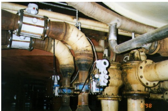
Medidor de vazão com válvula de controle de caldo
