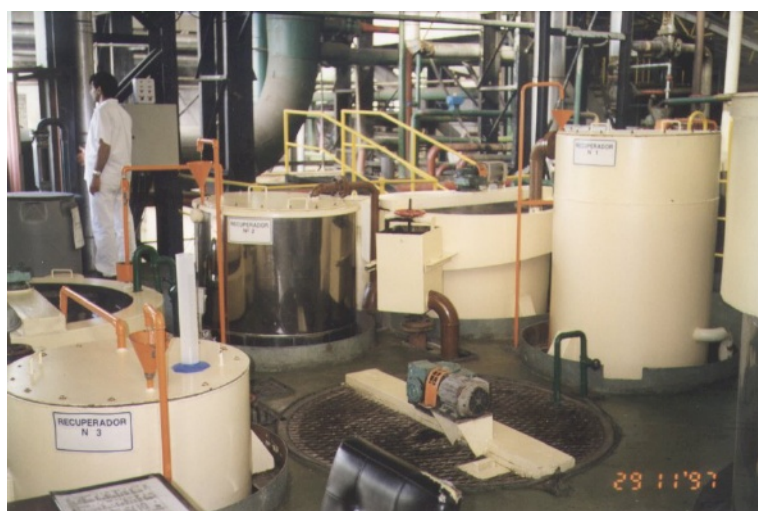
Clarificador e Recuperadores de Espuma - Refinadora Catarinense
