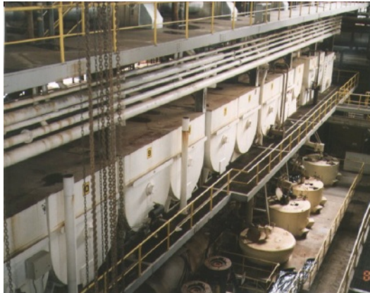
Conjunto de Cristalizadores e Centrifugas Contínuas - Usina Maracá
