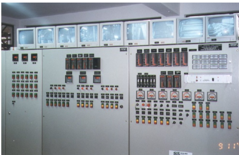
Painel de Controle de Caldeiras - Usina São Luiz de Ourinhos
