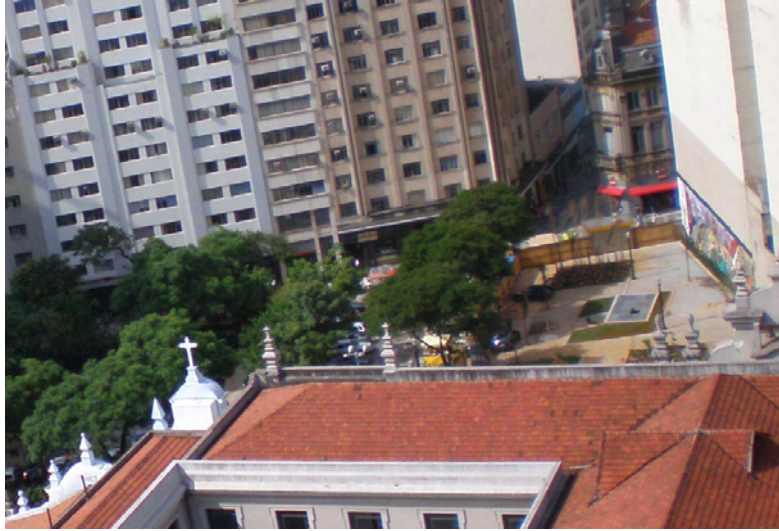
IMAGEM 435: Foto aérea da Praça Paulo Duarte, em obras, dia 3 de janeiro de 2008.
