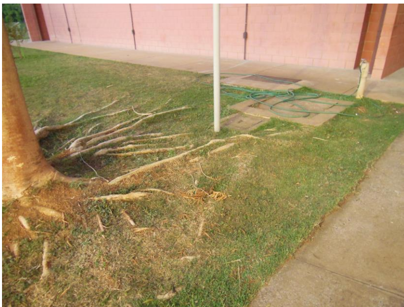
Figura 13. Raízes da espécie farinha seca no prédio da Engenharia Ambiental
