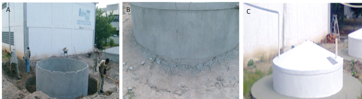
Figura 12: Aterro lateral da cisterna: (A) enchimento; (B) erosão devido à má compactação; (C) calçada lateral
