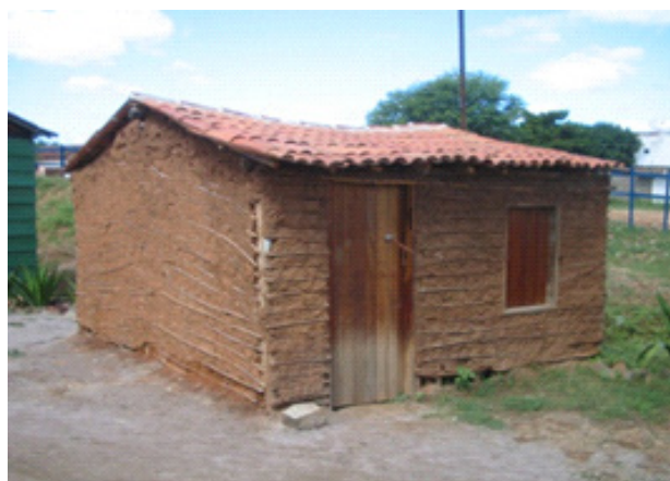
Figura 2. Casebre de taipa com telhado pequeno e deformado
