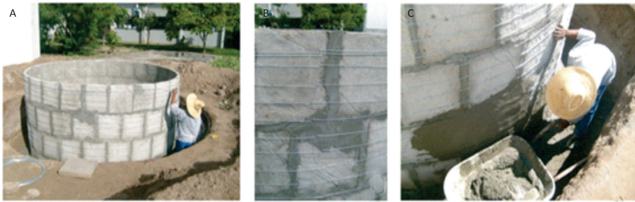
Figura 7. Amarração da cisterna com arame: (A) distribuição do reforço. (B) aperto com alicate; (C) reboco
