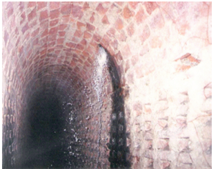
Figura 3. Galeria filtrante em funcionamento. Foto: Vargas (2010)
