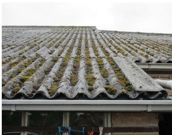
Figura 5. Telhado de amianto contaminado por musgos numa casa rural na Holanda
