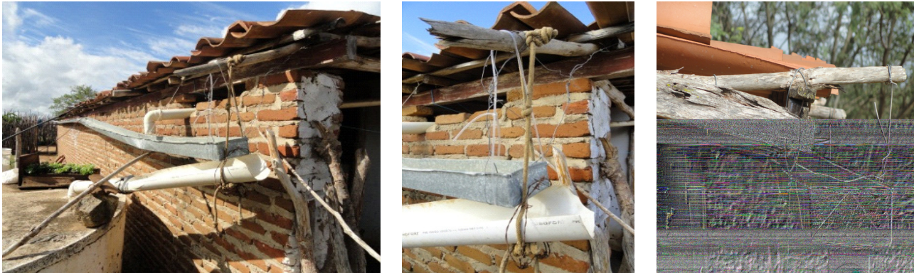
Figuras 10, 11 e 12. Improvisação de suportes de calhas e condutores com materiais inadequados
