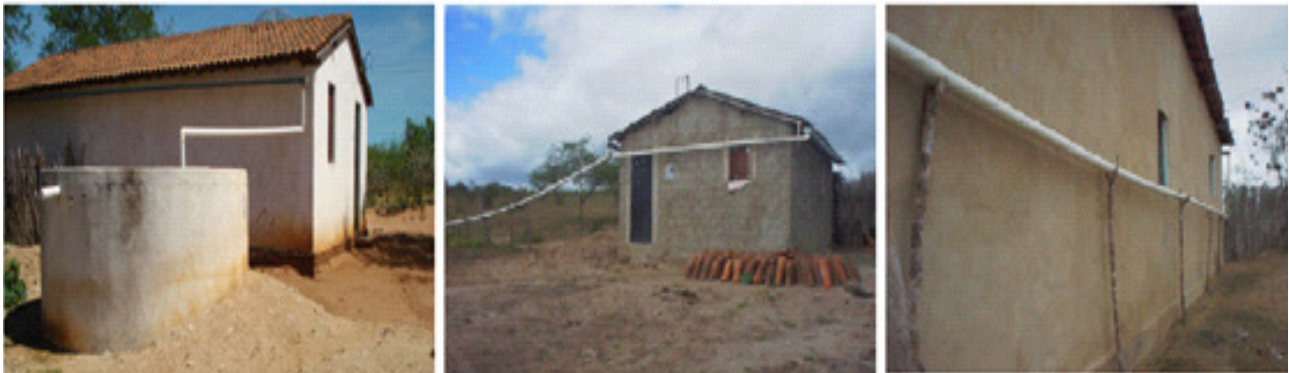
Figura7. Condutores suspensos expostos a intempéries, fixados por meio de suportes improvisados
