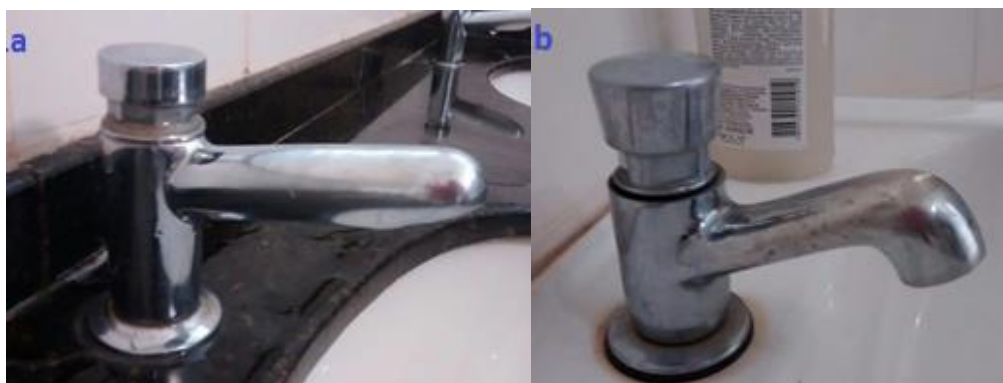
Figura 7 – 7a)Torneira convencionais; 7b)Torneira do sanitário de deficientes
