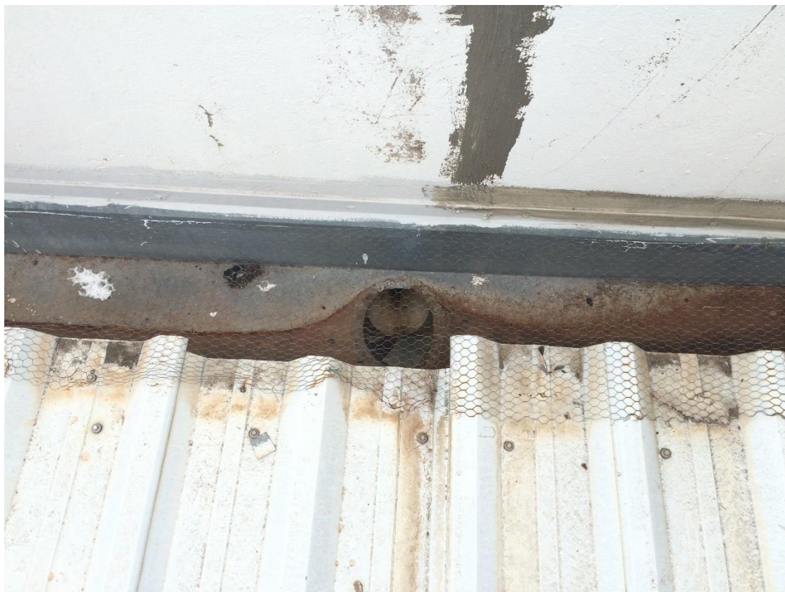
Figura 6. Ponto de concentração da água da chuva no telhado.
