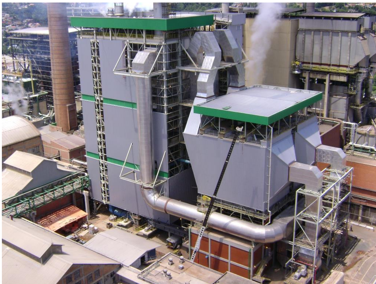
Figura 19 – Caldeira de recuperação de álcalis (Fonte: CBC)
