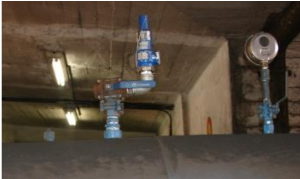
Figura 31 – Válvula esfera de 3 vias instalada entre o vaso de pressão e a válvula de segurança (Fonte: Autor)
