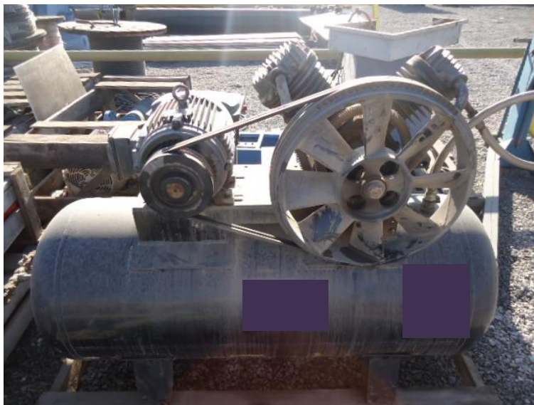
Figura 27 – Reservatório do compressor de pistão (Fonte do autor)
