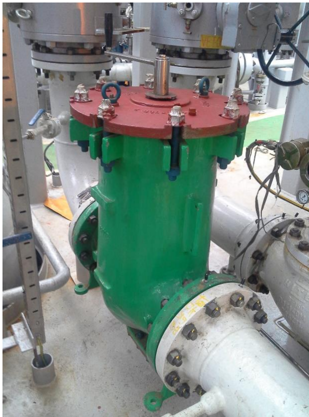
Figura 14 – Filtro suportado pela tubulação
