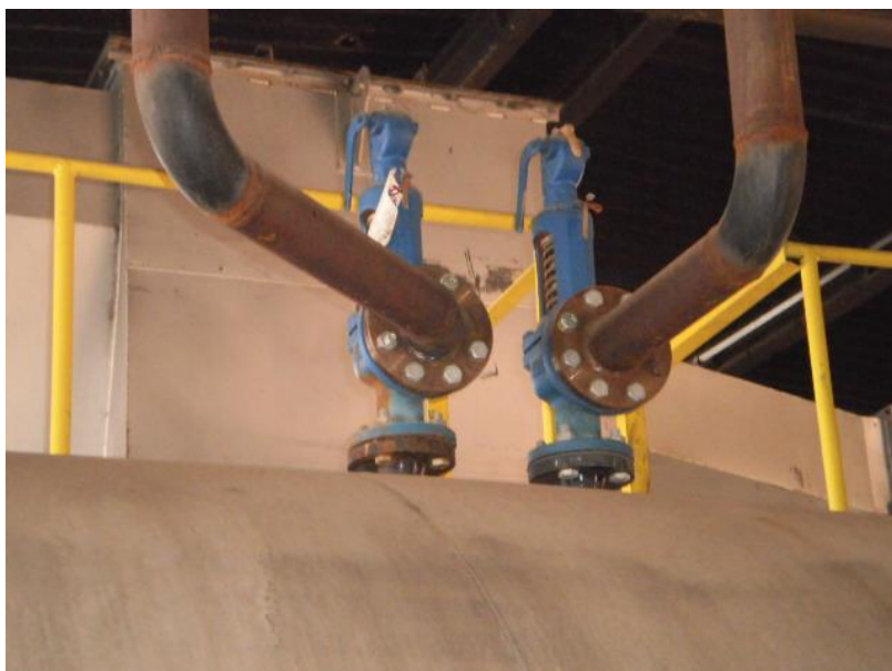
Figura 15 – Foto de duas válvulas de segurança instaladas em caldeira flamotubular (Fonte: autor)
