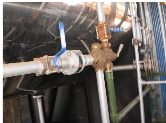
Figura 18 – Foto de injetor em caldeira a lenha (Fonte do autor)
