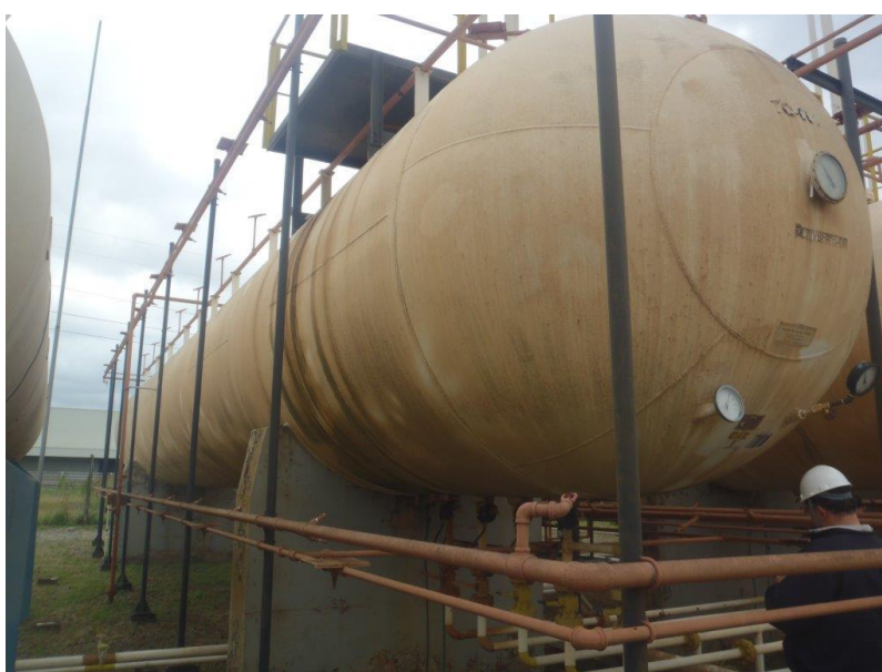
Figura 28 – Vaso de pressão de GLP (Fonte do autor)
