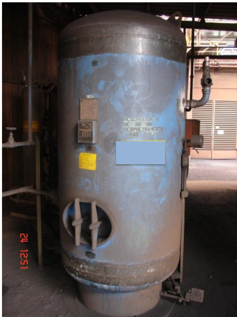
Figura 26 – Reservatório de ar comprimido (Fonte do autor)
