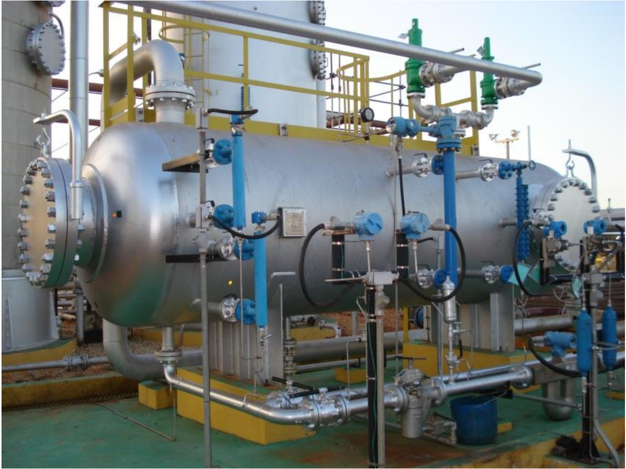
Figura 23 – Vaso separador (Fonte do autor)
