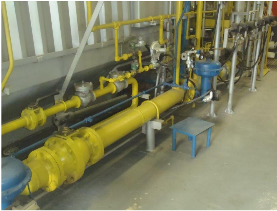
Figura 33 – Skid de gás natural ao lado de uma caldeira (Fonte do autor)
