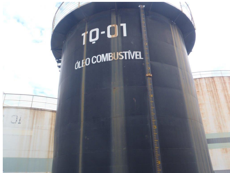
Figura 06 – Tanque de óleo combustível (Foto do autor)
