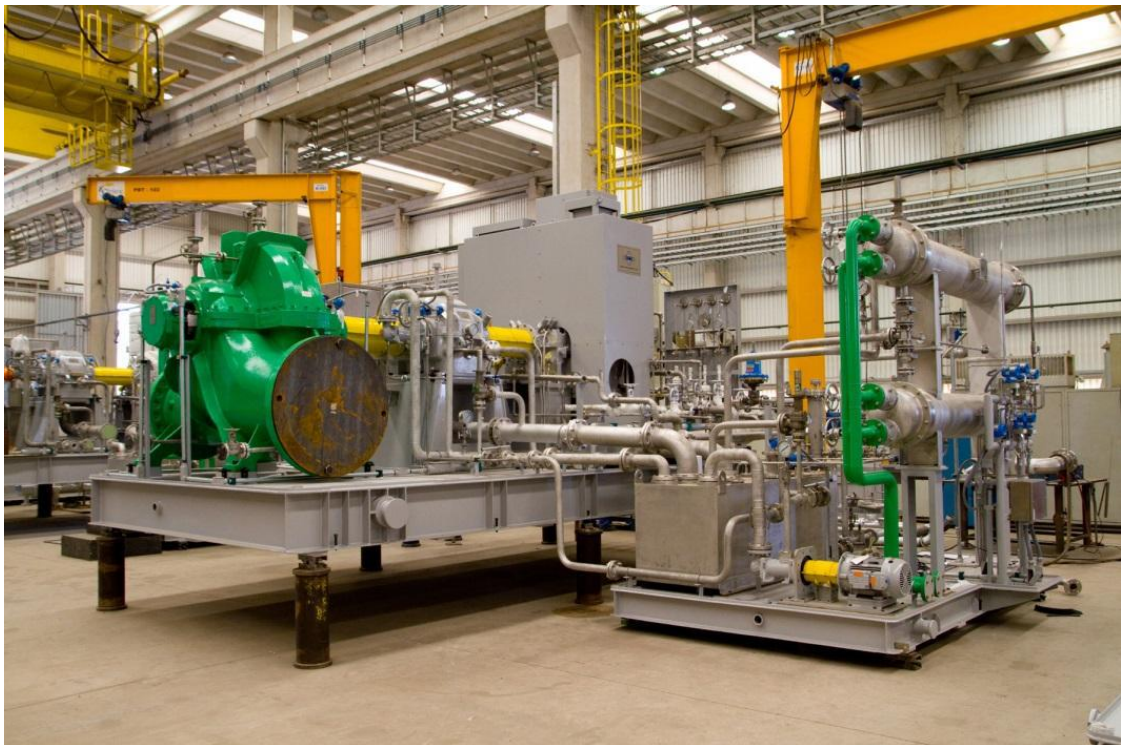
Figura 5 – Vaso de pressão de sistema de lubrificação de turbinas a vapor, em skid separado da turbina
