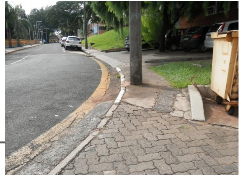
Figura 10: Ponto crítico da calçada. Fonte: Grupo 4a
