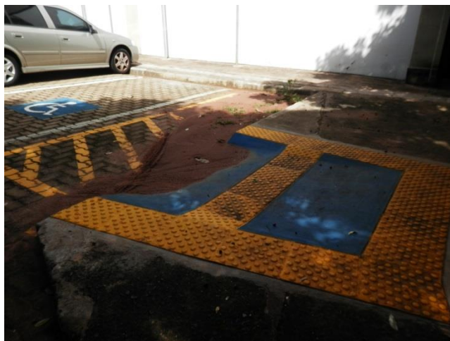
Figura 18 – Identificaram-se pontos em que há infraestrutura, mas falta manutenção para que se promova, de fato, o benefício da solução implantada. Fonte: Juliana Barberio. Data: 23/03/2015.
