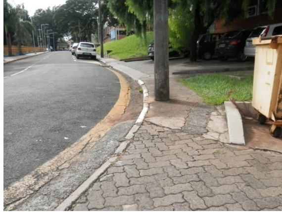
Figura 15 – Ponto crítico de calçada: torna-se muito estreita e esburacada (impossibilidade de cadeirantes). Fonte: Isabela Pontello. Data: 23/03/2015.
