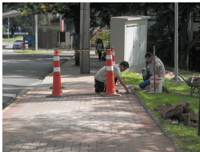
Figura 4 – A foto foi realizada em frente ao Instituto de Arquitetura e Urbanismo, e comprova que, ao menos nesta área, a manutenção de calçadas está sendo feita, e devidamente sinalizada. Fonte: Isabela Pontello. Data: 23/03/2015.
